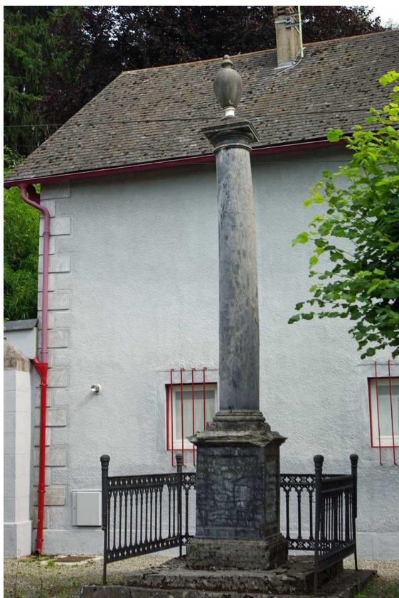
La colonne devant la maison natale du général Lafaille à Pouzac est en très mauvais état. (Photo D. Timmermans)
